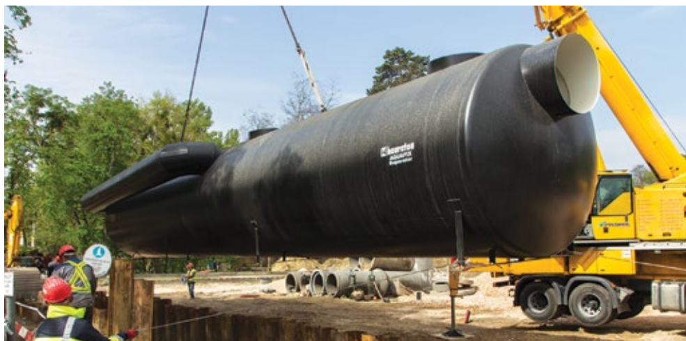
Az Építők parkjánál elhelyezett iszap- és olajfogó a kertvárosi csapadékvíz megtisztítását szolgálja
