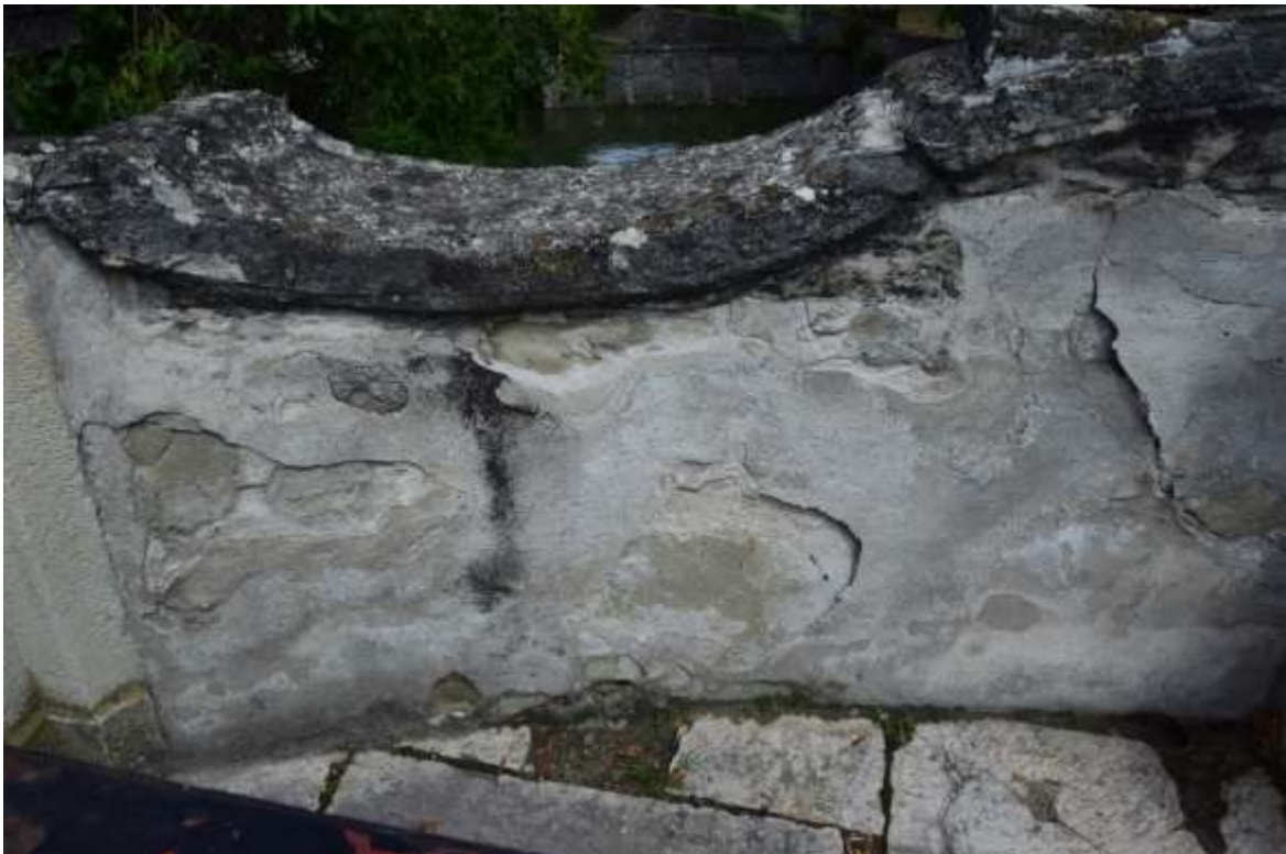
Pusztulófélben lévő fedkövek és felleveledett vakolat (FK1).
