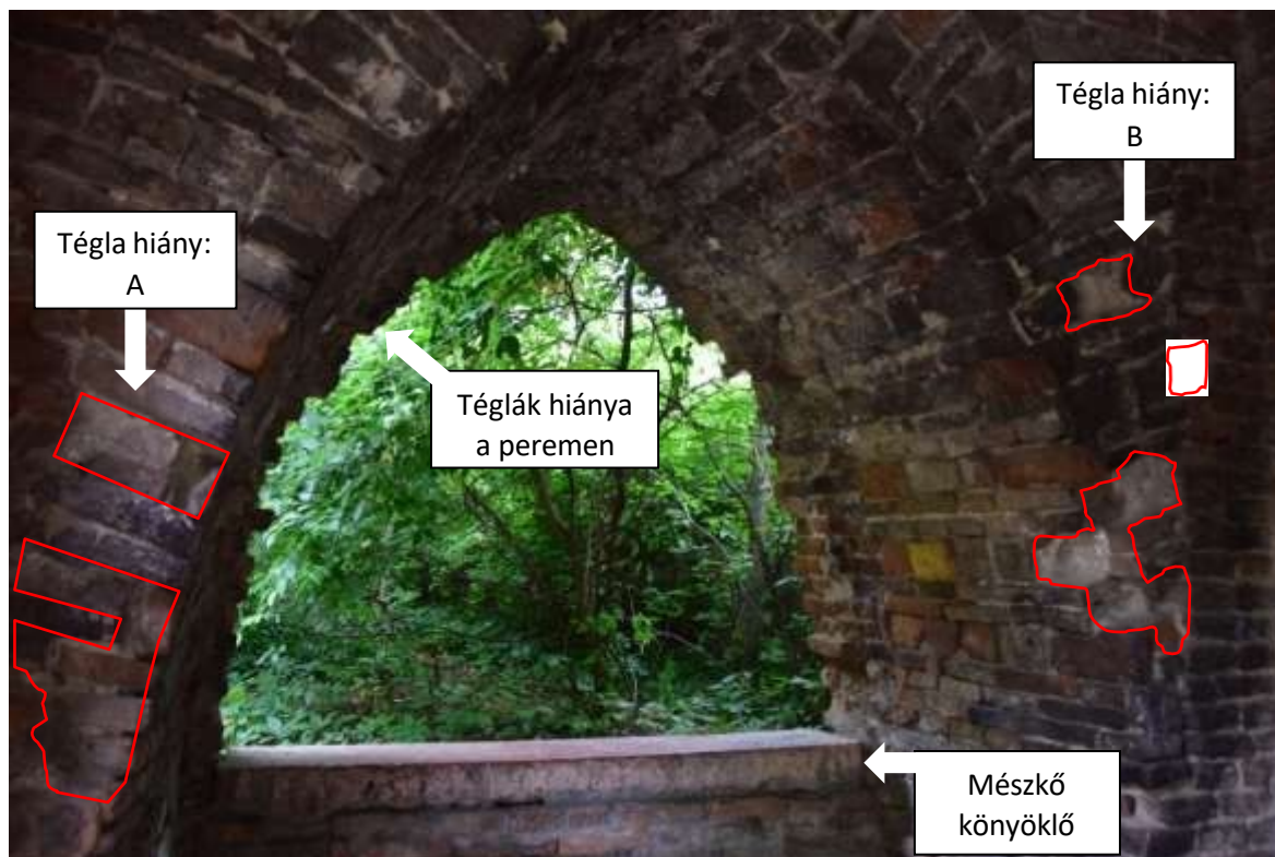
Hiányzó téglák a falazaton, a nyíláskeret külső peremén lévő téglaelemei szinte 75%-ban kiestek, roncsolódtak. Az ablaknyílás tömött mésző könyöklő fugái is hiányosak.
