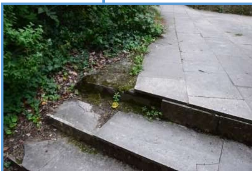
Felvált, hiányzó, repedezett, kimozdult burkolókövek.
