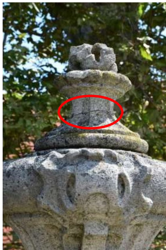
Átmenő repedés a fáklya nyakán.
