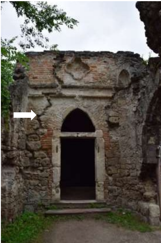
Műrepedés a falazaton
