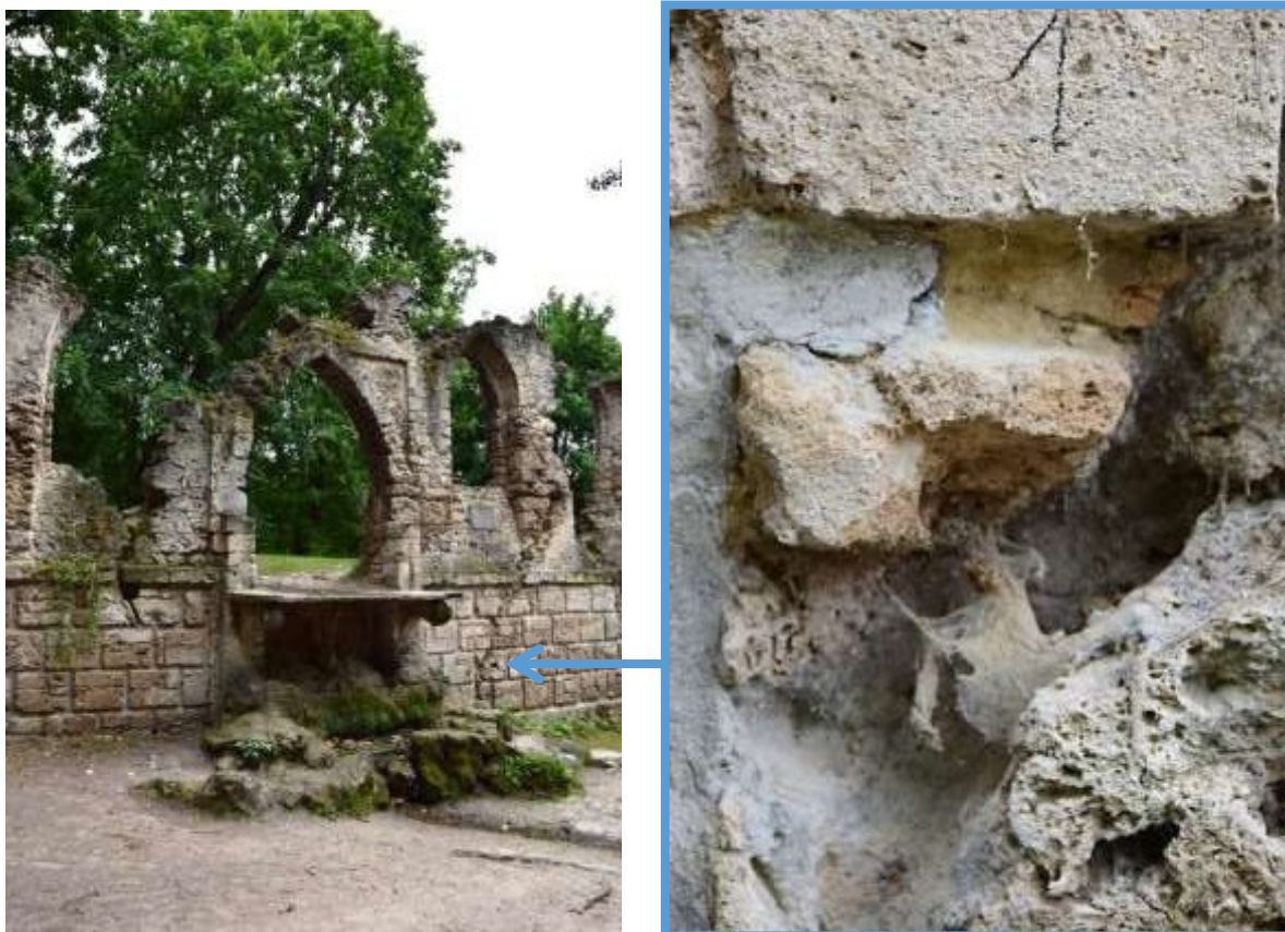
Cementes álfuga a meszes fugán, málló fugák és vakolat, rossz megtartású kőelemek (bővebben: Műemlékdiagnosztikai statikai szakértői szakvélemény)
