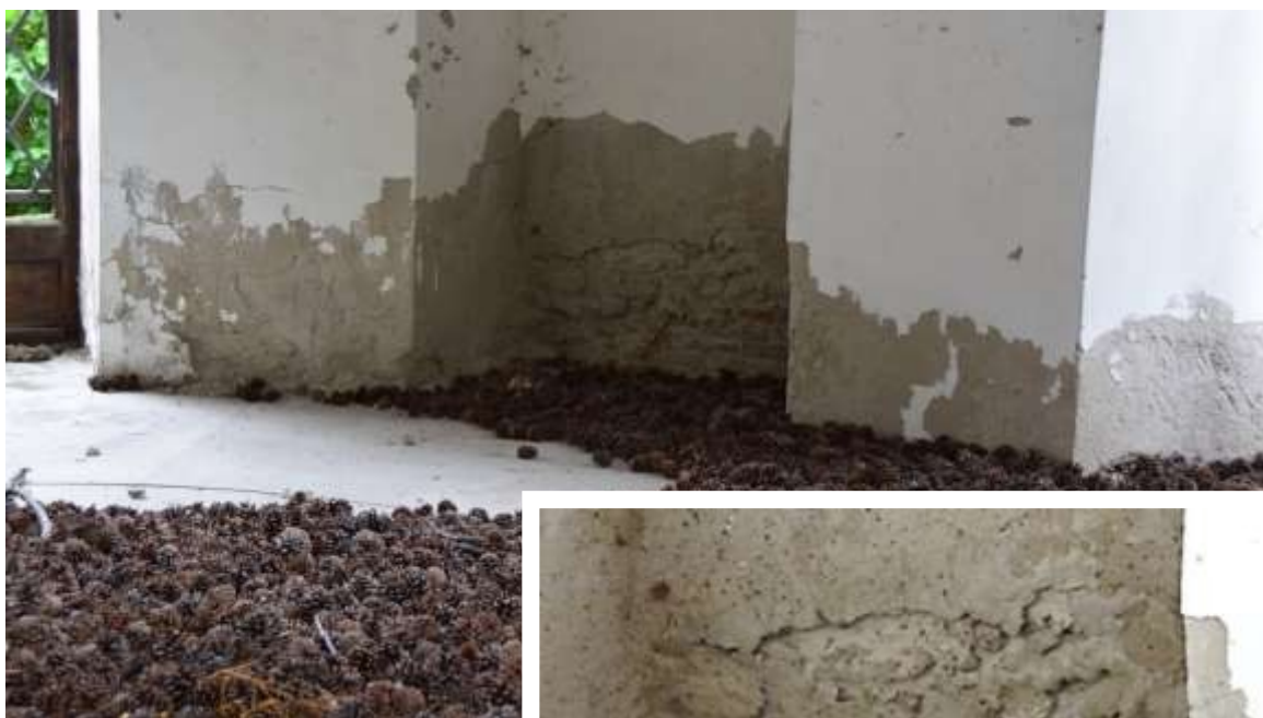
Tégláig levált vakolat.
