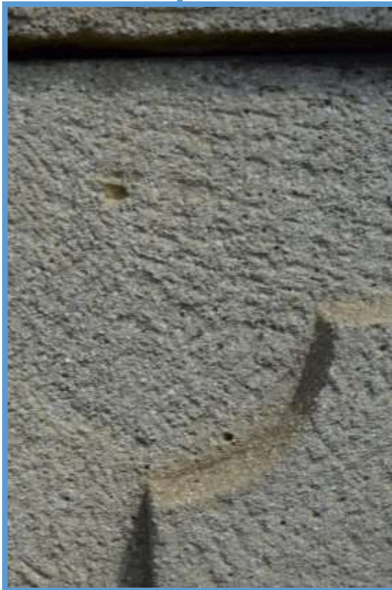
Újszerű műkő kiegészítés (FK1).
