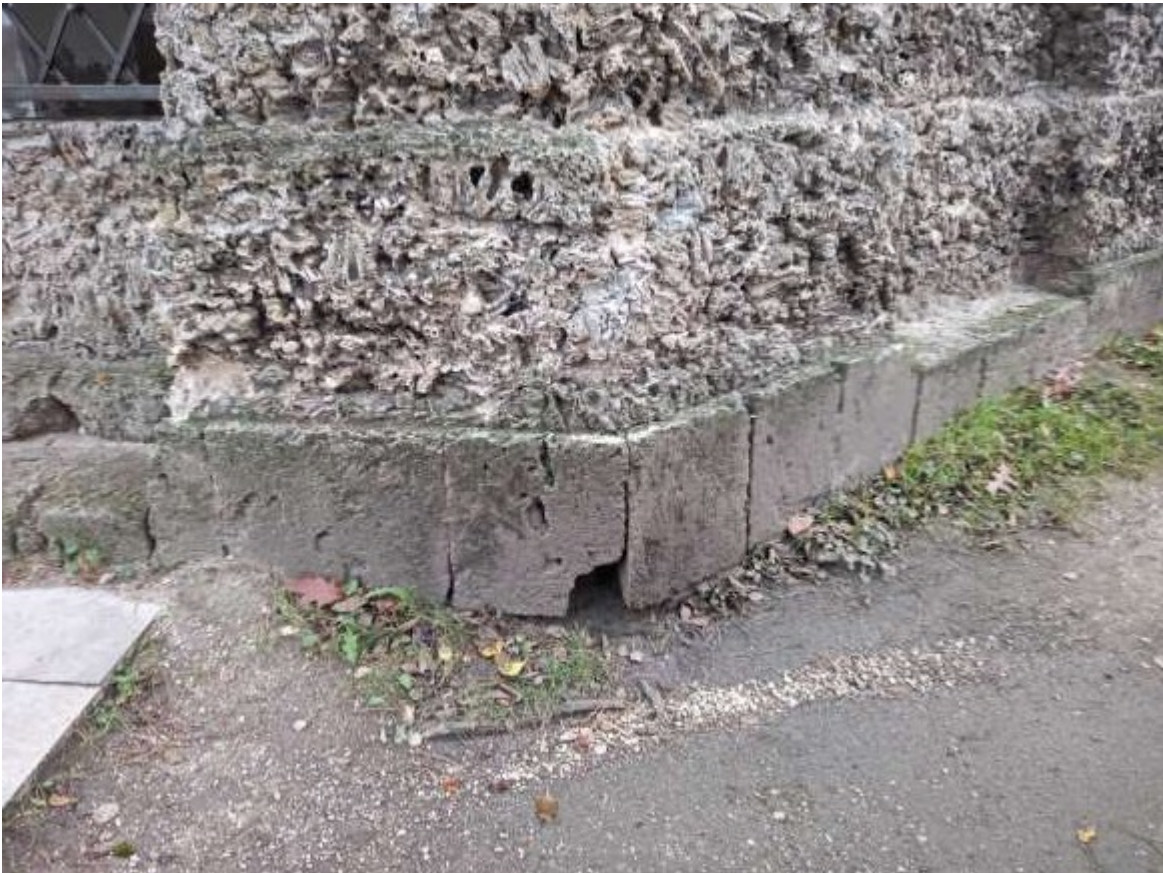
Víző által kimosott vízgödör. Eső esetén nem csak a vízköpőből, de a környezetéből is ide gyűlik az esővíz és nedvesen tartja a falakat.
