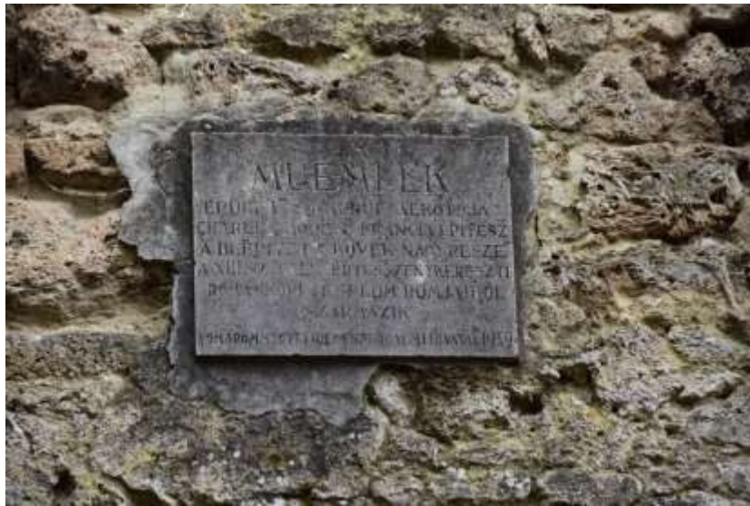
Szennyezett felület. Cementes beépítés mögött kimállott fuga.
