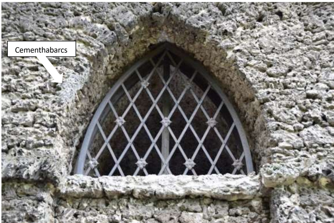
Kis cementes kiegészítések, málló, hiányos zárókövek. Eredeti alakjuk már nehezen kivehető, ami pajzs alakú lehetett.
