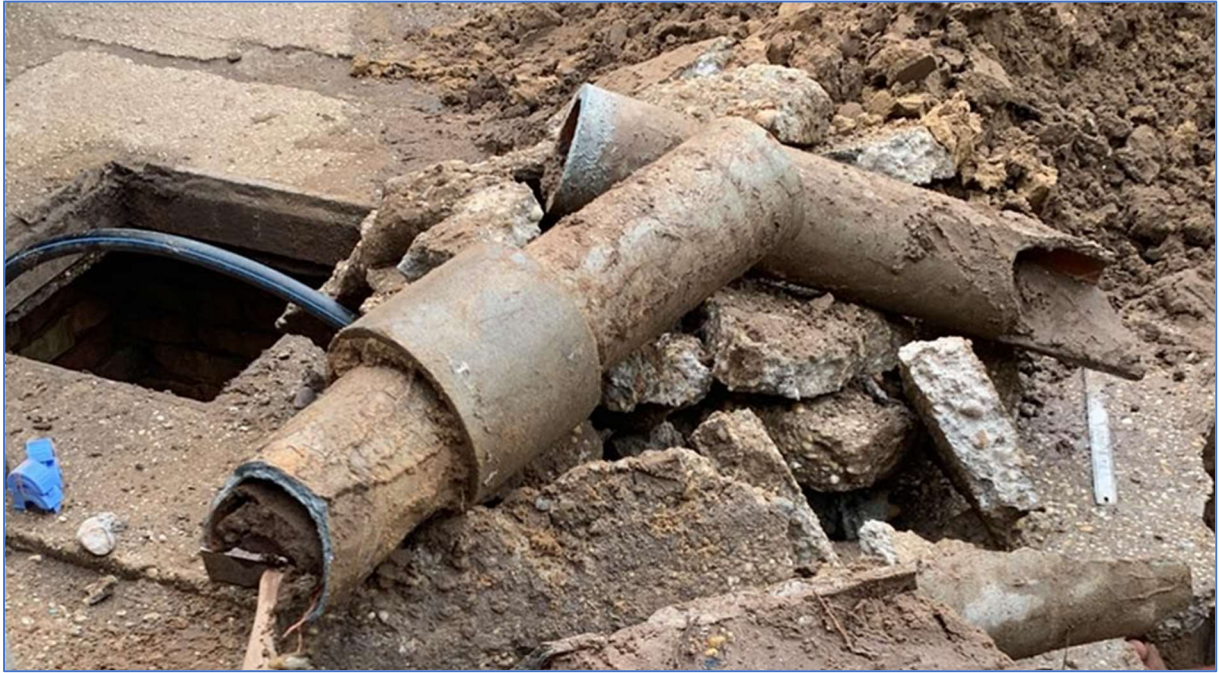
137. ábra: Elamortizálódott, csőtörést szenvedett vezetékszakasz, Tata város, Akácfa utca
