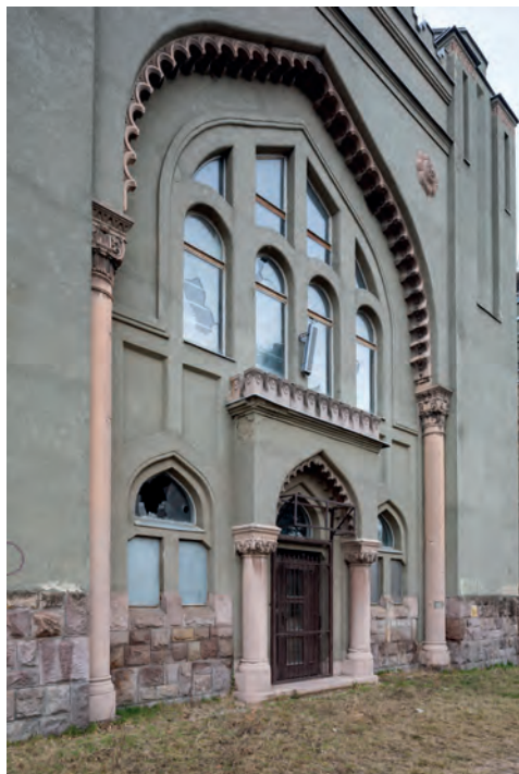
15. kép. A gyöngyösi zsinagóga oldalsó bejárata, a hiányzó ablakkal.
